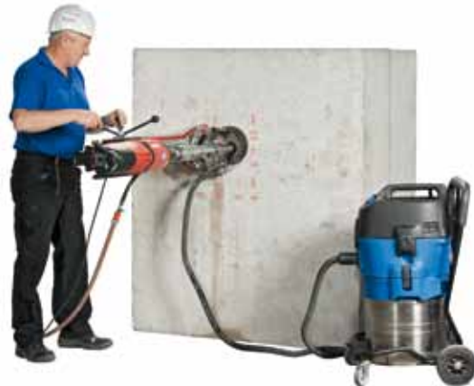
Rote Markierungen zeigen die Bewehrungslage an. Schonen der Bewehrung durch Herstellen der Kernbohrung zwischen den Bewehrungsstäben.
